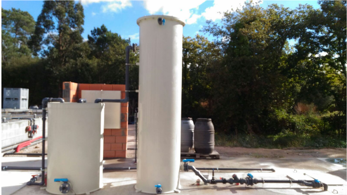
Foto 1: Digestor anaerobio HUSB y pozo bombeo
